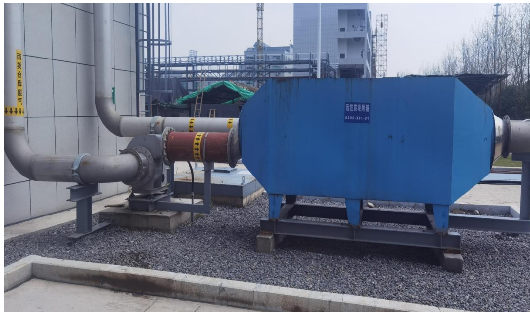
危废仓库废气处理设施
