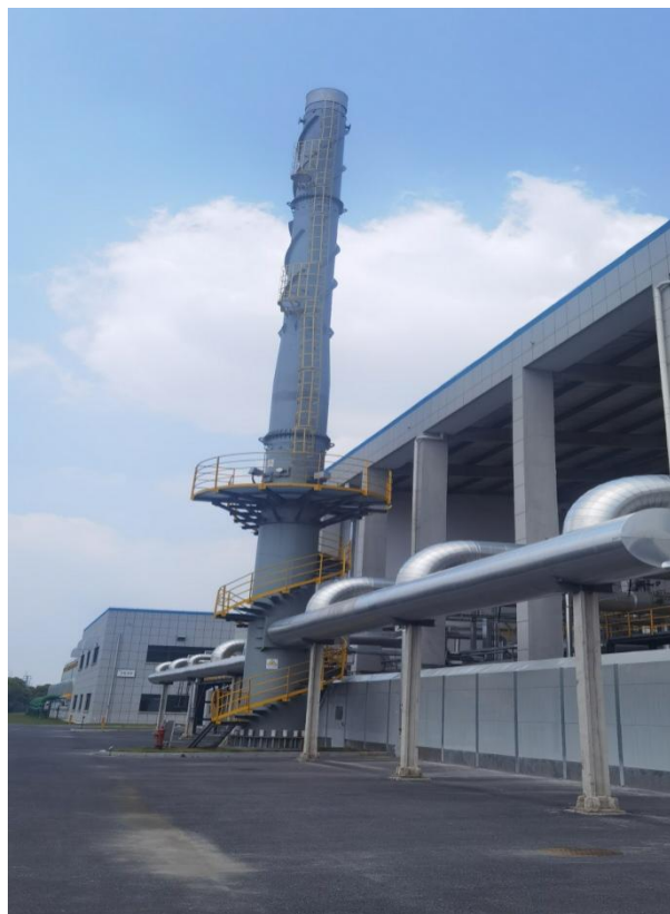
热媒中心天然气锅炉
